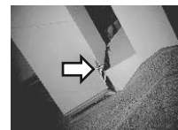
大ホール客席天井一部損傷の様子
