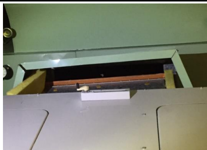
⑦ 大ホール客席系統空調機 (5階機械室)ダクト損傷
