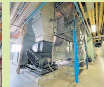
空調機械室ダクト
