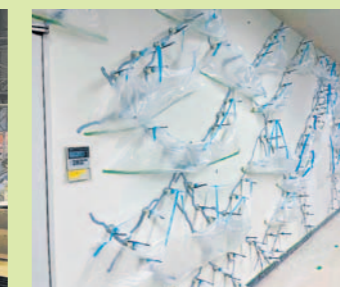
壁クラック(1階)
